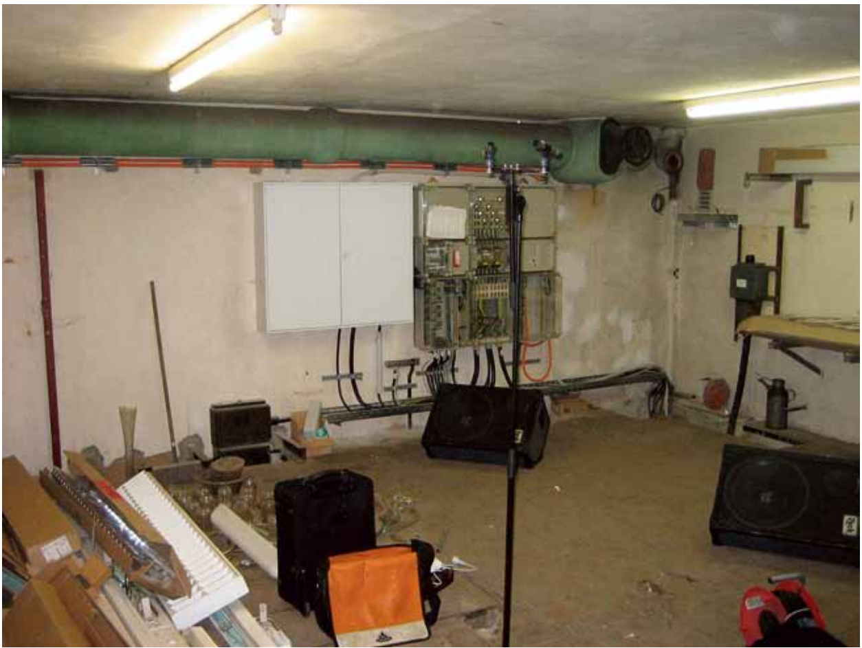
«Friedrich-Engels-Straße 27, 34117 Kassel. Erbaut 1941. Kellerraum eines Hochbunkers. 18 qm. Neonbeleuchtung. Reste alter Lüftungsanlagen.» (Aus Martin Schüttlers Radiostück «Leerstand», 2009)
